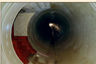
Zulauf des Überlaufs in das Speichersiel.
