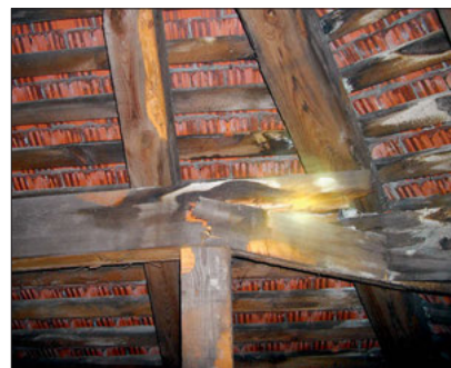
Die Balken im Dachstuhl der Kreuzkirche reißen. Foto: Kreuzkirche
