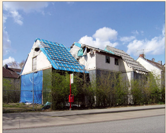
Auf diese Bauruine in der Stein-Hardenberg-Straße Nr. 45-49 machte uns ein Leser unserer Zeitschrift aufmerksam. Seiner Meinung nach befindet sich die Anlage seit über zwei Jahren in diesem erbärmlichen Zustand. Aus einem Bauschild geht hervor, dass die ANBUD-BAU GmbH hier Mehrfamilienhäuser mit sechs Wohneinheiten und fünf Stellplätzen errichtet.
