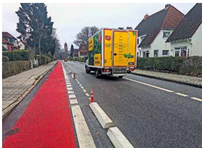
Undurchdachte Fahrbahnsanierung in der Tilsiter Straße.
