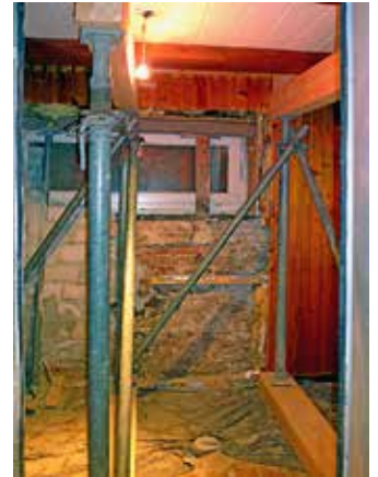
Teile des Gebäudes mussten im Inneren abgestützt und gesichert, sowie der Gastraum gegenüber dem Tresen geschlossen werden. Foto: Thorsten Richter
