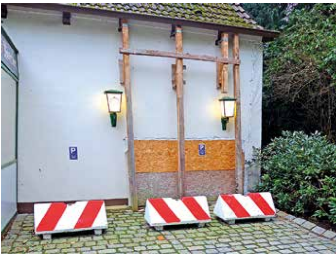
Ein »Parkunfall« beschädigte die Fassade und dadurch wurde der marode Zustand des Hauses sichtbar. Das gesamte Gebäude muss kernsaniert, wenn nicht sogar abgerissen werden. Foto: Thorsten Richter
